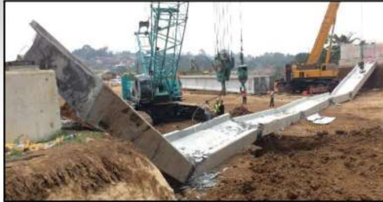
Kondisi Saat Kecelakaan Konstruksi
