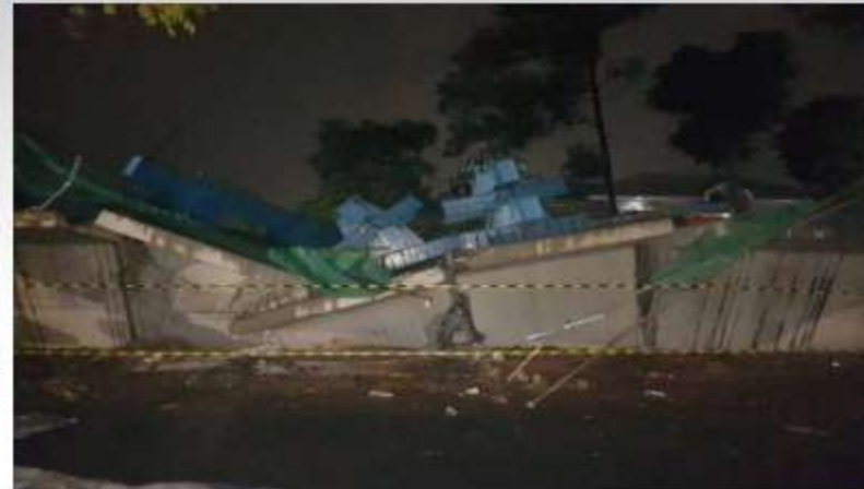
Kondisi Saat Kecelakaan Konstruksi
