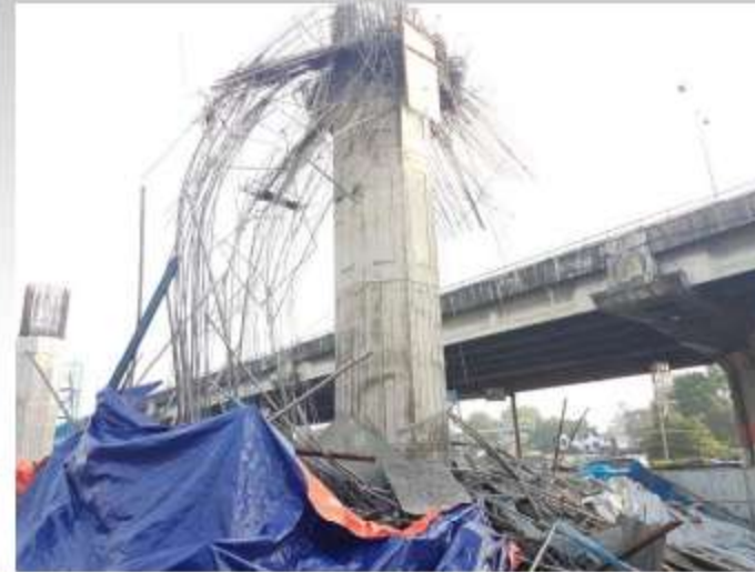
Kondisi saat Kecelakaan Konstruksi
