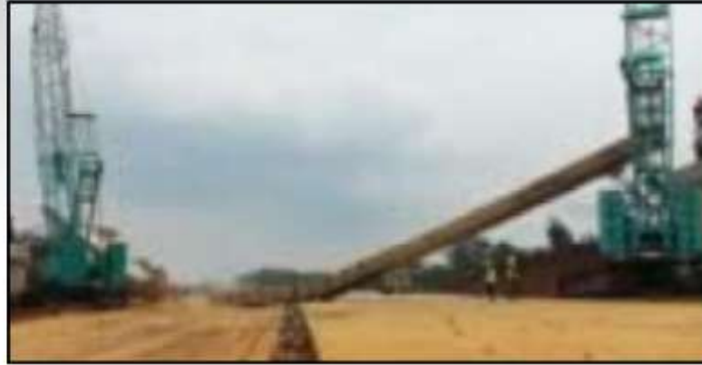
Kondisi Saat Kecelakaan Konstruksi
