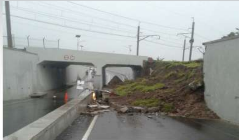
Kondisi saat Kecelakaan Konstruksi
